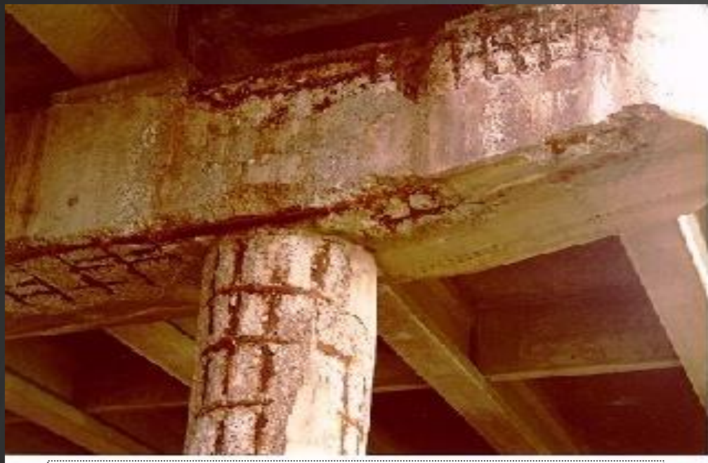
Рис.7. Коррозия стальной арматуры на примере опоры и балки автомобильного моста
